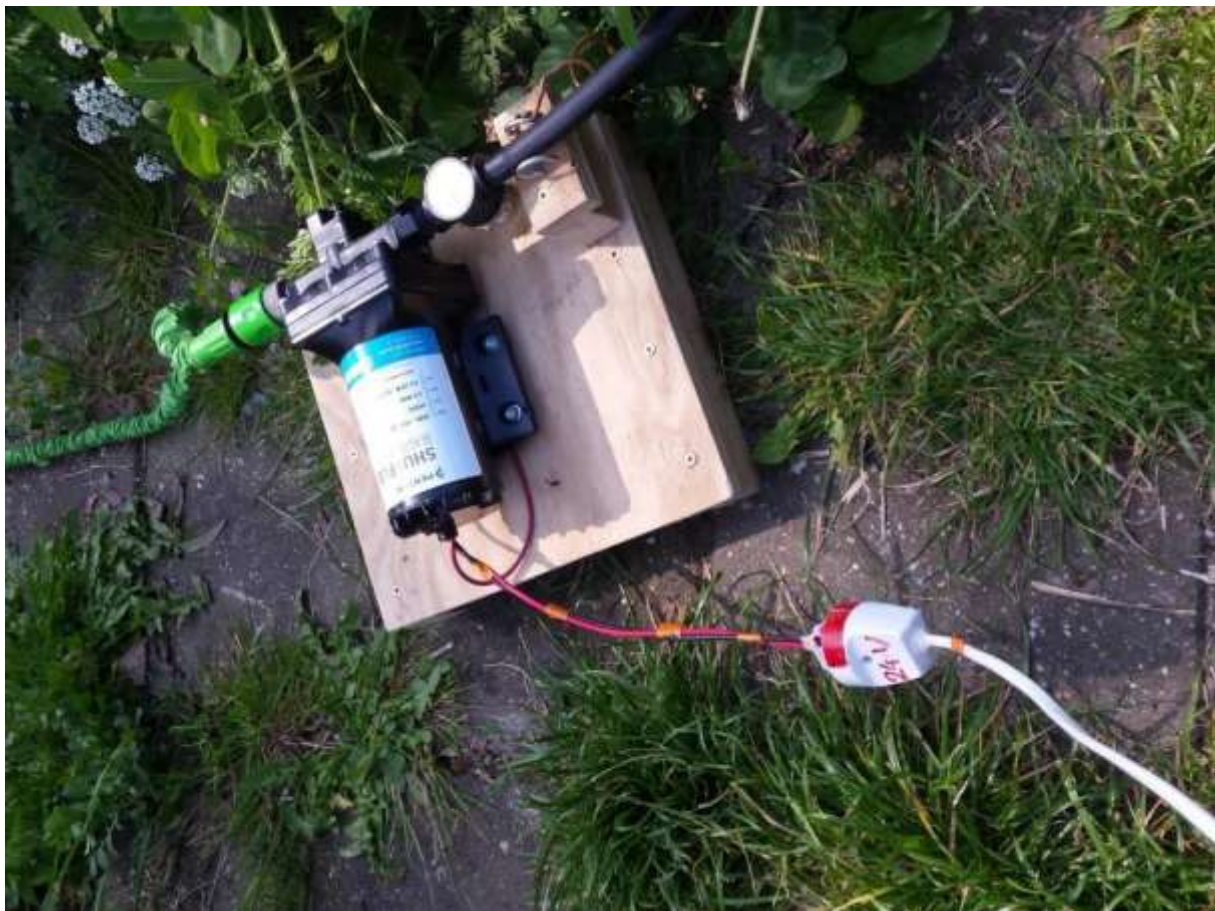
Foto-15 pomp en electra-bedrading
